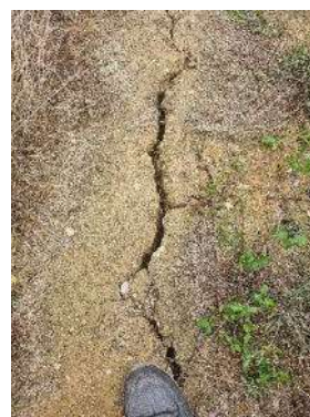
Figura 6 - Fendas de tração na crista do talude.
