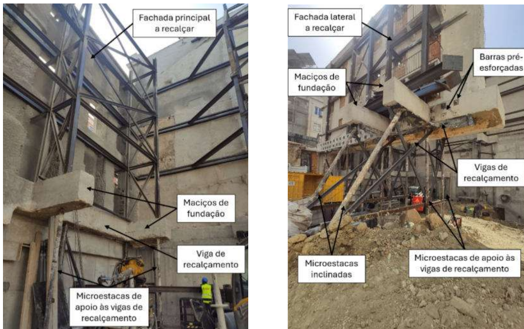
Figura 7 - Fotografia capturada no decorrer dos trabalhos em obra, com identificação de alguns dos elementos mais relevantes, alçado confinante com a Calçada da Estrela (à esquerda) e fachada lateral nascente (à direita)
