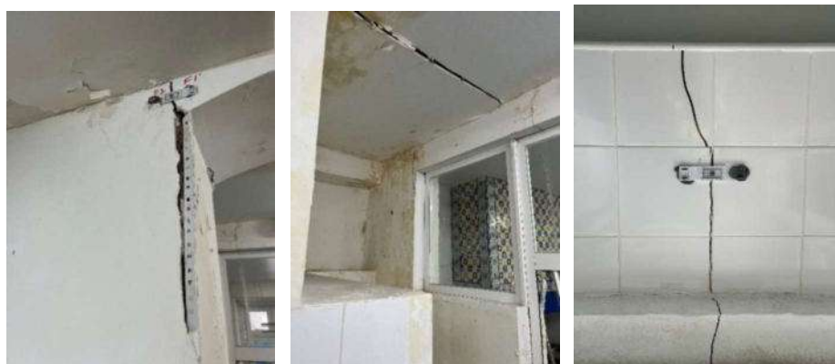
Figura 3 - Algumas fissuras observadas junto ao alçado de escavação
