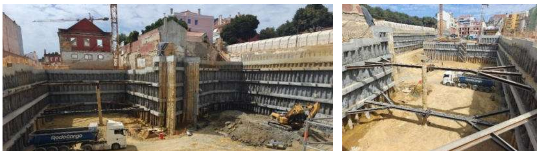
Figura 18 - Vista Norte e Sul da Solução de Contenção Periférica em Fase Final de Escavação
