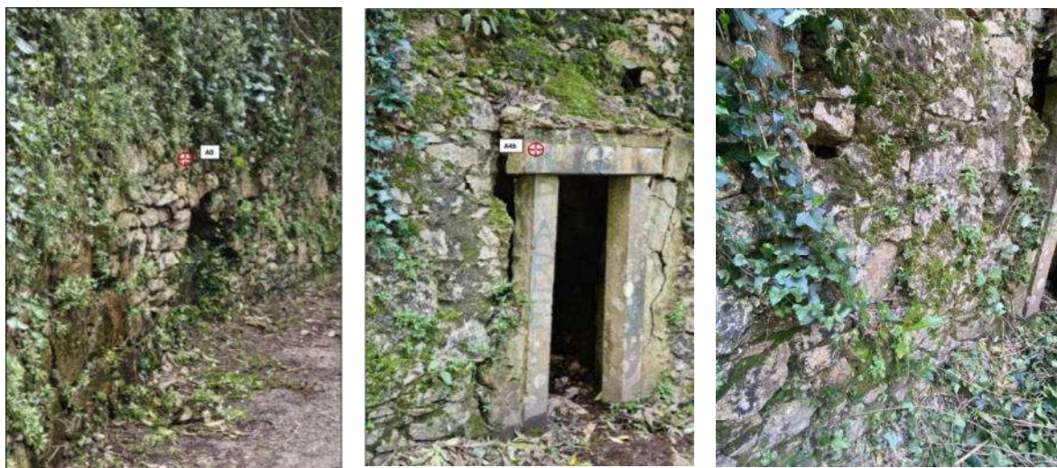
Figura 3 – Identificação de algumas patologias
