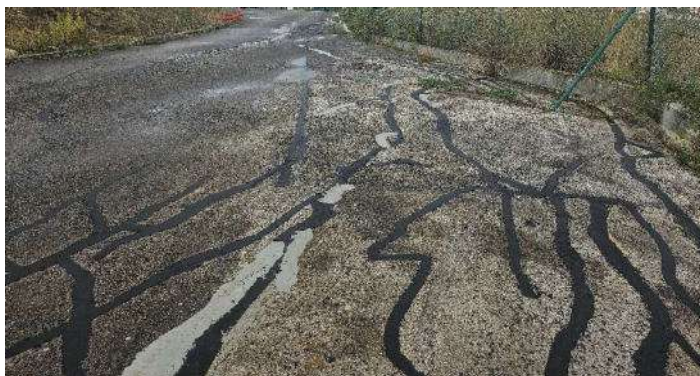
Figura 5 - Patologias visíveis na zona de acesso aos reservatórios.
