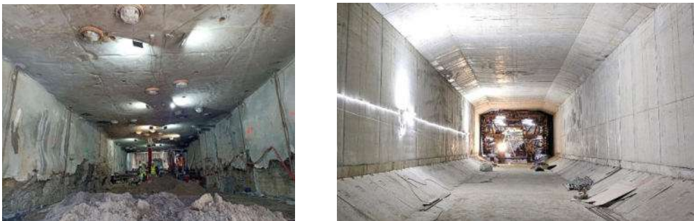
Figura 25. Vista sob a laje de recalçamento com as estacas de fundação do edifício demolidas (esquerda) e com a estrutura definitiva do túnel construído sob a laje de recalçamento (direita).
