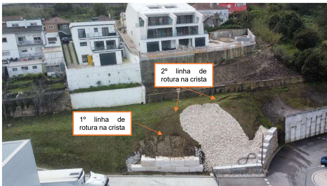
Figura 2 – Talude após a instabilização.
